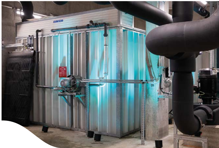
Der Eisspeicher am MedUni Campus Mariannengasse: Hocheffizienter Kältemaschinen bringen Wasser auf fünf bis sechs Grad Celsius, das im Gebäude verteilt für angenehme Abkühlung sorgt.
